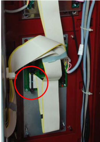
Abbildung 1 Das Kabel wird nach unten geführt und zur linken Seite geknickt
